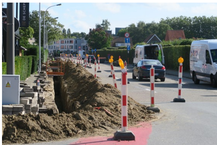
De omgeving van brasserie De Schepper is herschapen in een werfzone. De brasserie blijft open en is bereikbaar. FOTO JAN AUMAN
